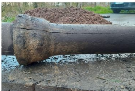
Une des tulipes de la canalisation d'eau fendue par la foudre. ©Document remis à la rédaction
