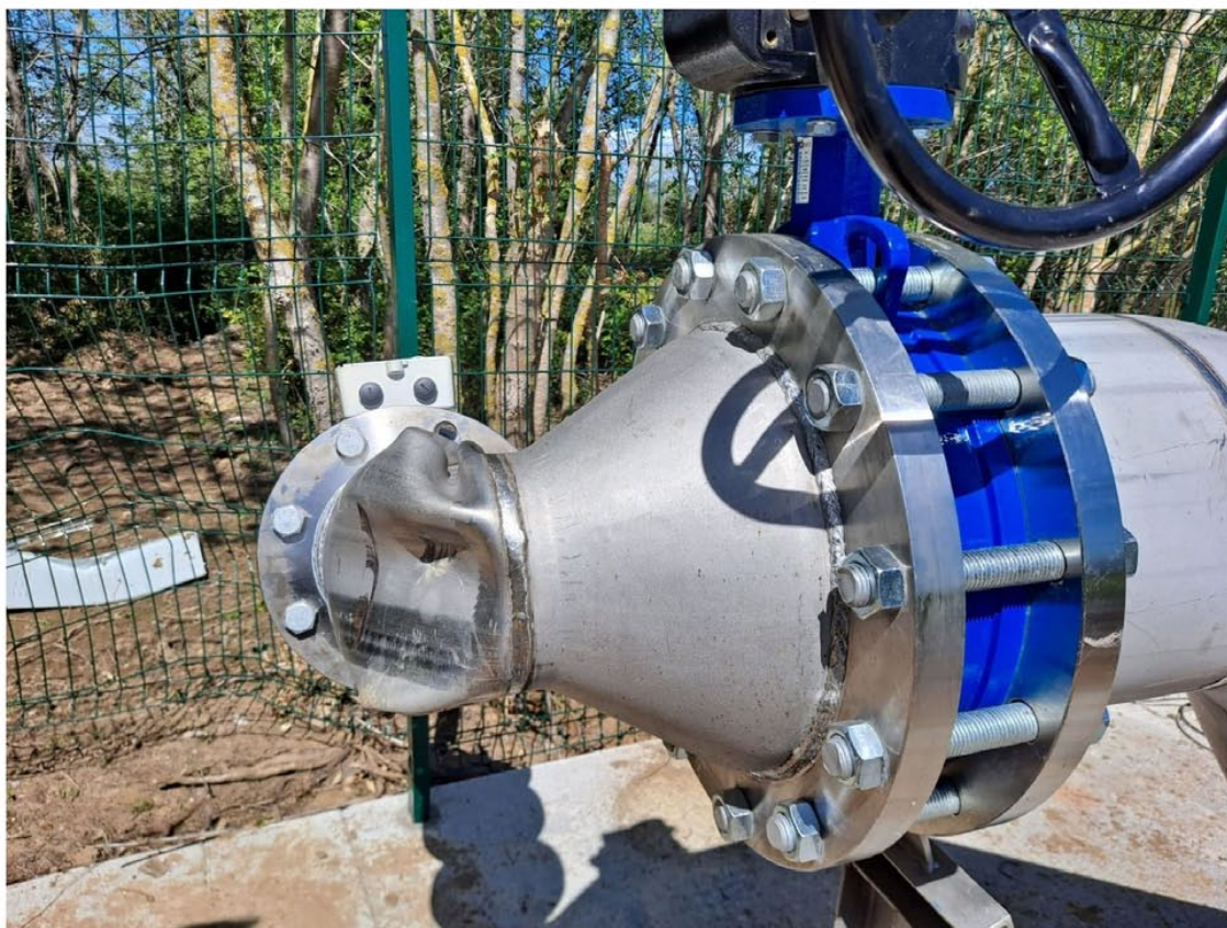
Una de las tuberías saboteadas de un pozo en Girona.
