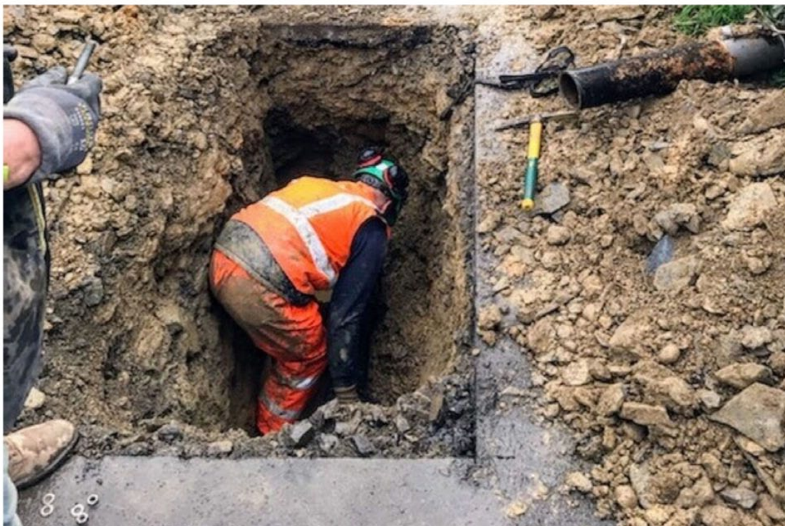
La rue communale du presbytère au bourg est transformée en « gruyère » avec sept trous pour réparer les fuites d'eau. ©Document remis à la rédaction
